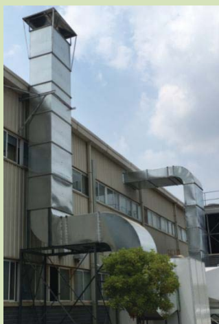
护层活性炭处理装置及排气筒（3#、4#一致）
