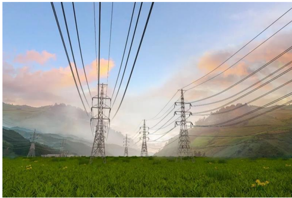
白鹤滩-浙江特高压工程
