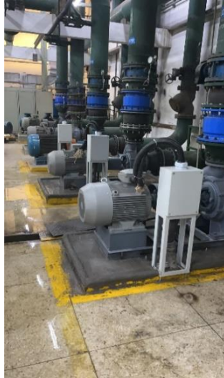
制冷站节能改造设备
