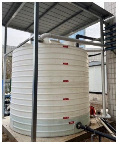
废水回收再利用系统
